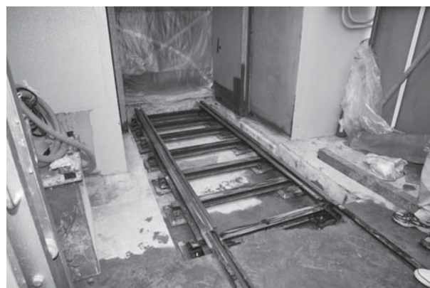
図10 遮蔽扉の修繕工事。開口部側にレールを再設置したところ。扉は写真の手前側に引き出されている。
