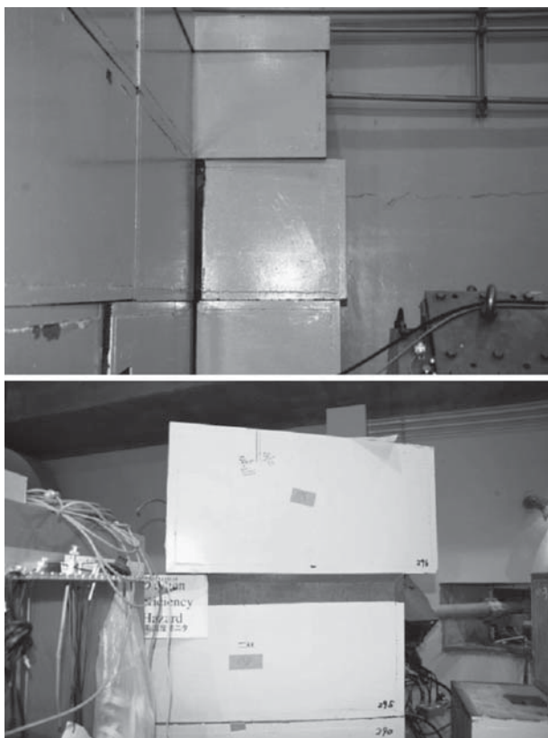
図8 ずれが生じた遮蔽ブロック
