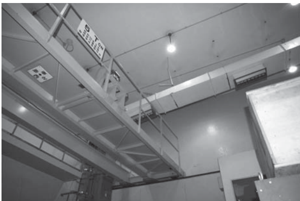
図6 落下して天井クレーンに乗った状態となった送風用ダクト
