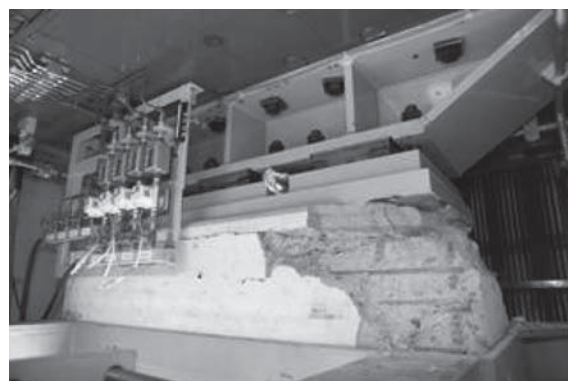
図3 損傷したサイクロトロンの支柱
