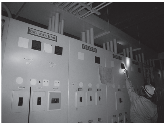
図7 3月14日に施設受電設備の主ブレーカーを切断。
