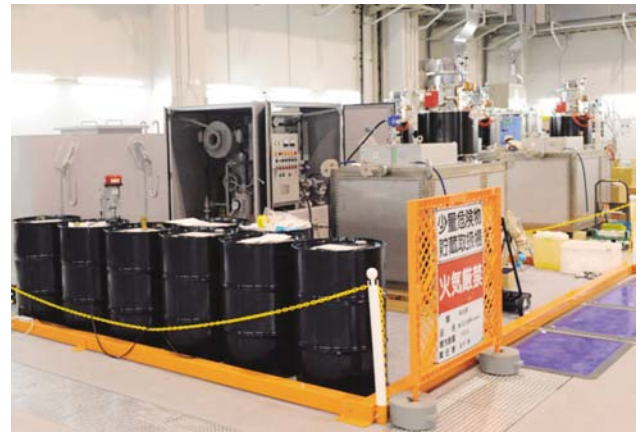
図6 絶縁油の注入. 200 L ドラム缶 8 本を真空浄油器(後方中央)にて脱気しながら注油する
