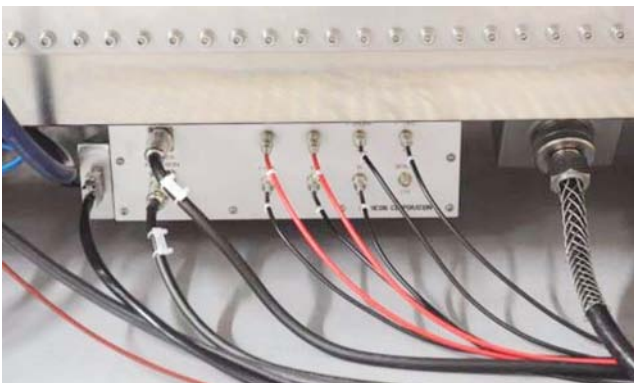
図14 左から冷却水インターロック，ヒータ電力，トリガ，電圧電流の波形モニター，右に 50 kV 充電口
