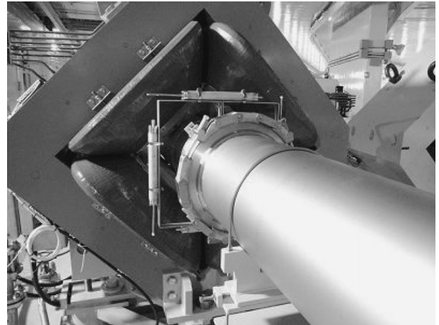
図7 ビームロスモニター（四極電磁石の上流側においてそれぞれ上下左右の4箇所に設置）
