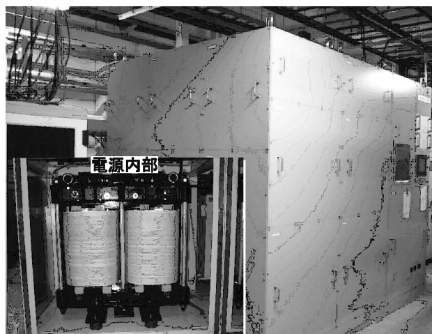
図6 パルス偏向電磁石電源及び内部リアクトル
