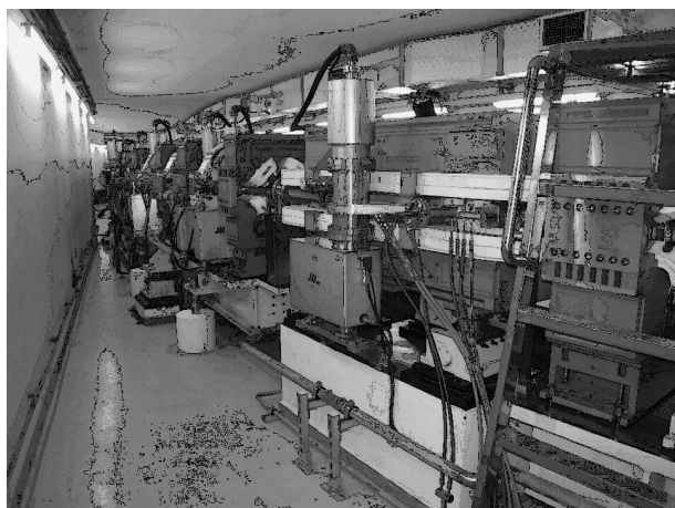
図5 電磁石及び架台をリング外側から見たところ
