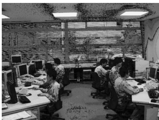
図12 中央運転監視制御室
