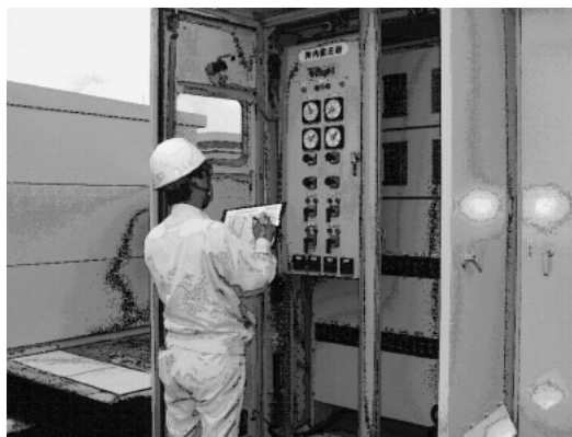
図13 電気設備の保守点検
