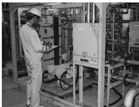
図23 点検例 (マシン系冷却設備)
