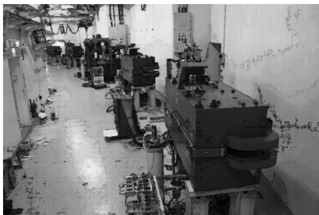
図8 偏向電磁石と挿入光源のみを残して、電磁石や真空ダクトがすべて撤去されたリングトンネル内。一番手前は偏向電磁石 B14，写真奥に見えるのが MPW#16。
