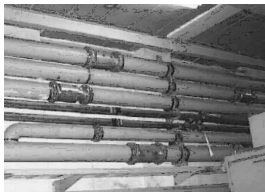
図7 クライストロン室東壁のタワー水系伸縮継ぎ手
