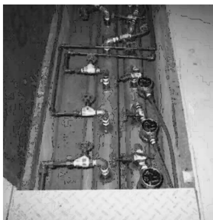
図4 ピット内に敷設された流量計
