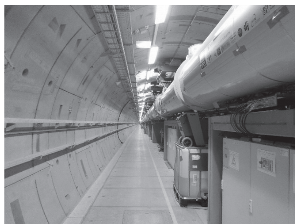
図2 EURO-XFEL の超伝導空洞クライオモジュールのトンネル内の設置の様子.
