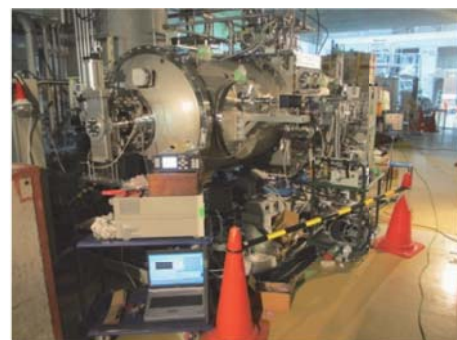
図8 (上) 主加速部クライオモジュール概念図と(下) cERL加速器室に設置された主加速部クライオモジュール。
