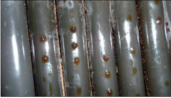
図7 油状の液体を出し続けるキャプタイヤーケーブル。ケーブル上部にはRRCの静電デフレクターがあり高速中性子にケーブルはさらされている。左端は新しく敷設したMLFC。写真は真下より撮影したもの。
