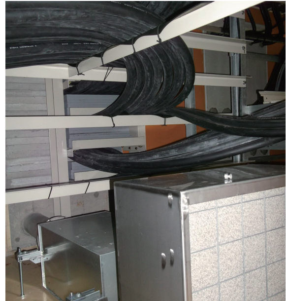
図6 下段左側がファン本体、右はフィルター。ファンで冷却空気を押し込み、上に見えるケーブルの隙間を流れ、冷やしながら戻ってくる。
