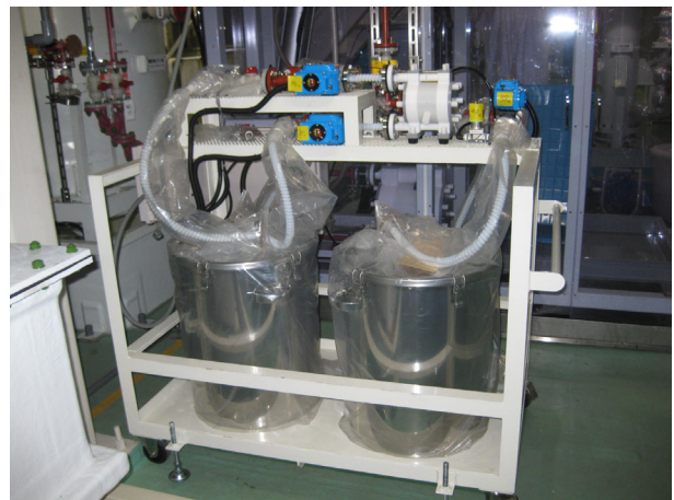
写真1 プレEP作業用のEP液タンク——1階部
