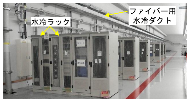
図4：XFEL棟クライストロンギャラリーに設置された水冷ダクトと水冷ラック
