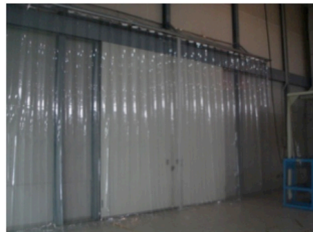
図3. 機器搬入扉に設置した断熱カーテン
