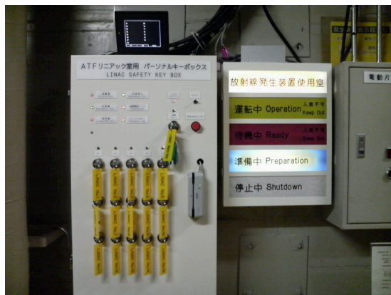
図5 リニアック室操作盤
