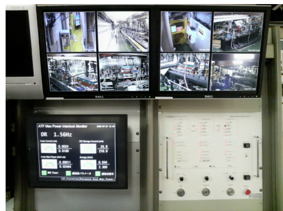
図4 制御室操作盤
