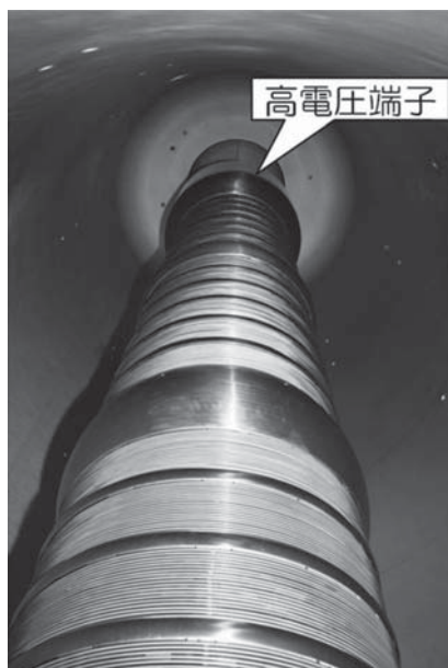
図1 加速器タンク内部の絶縁カラム 多数のリングで白く見える部分が絶縁部。 高さ20mの高電圧端子をセラミクスで支える。
