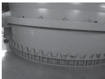
図5 圧力タンクの支持固定部分。M68 ボルト64本で3階基礎部に固定されている。
